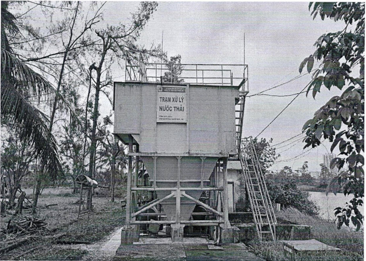
Hình 3.6. Trạm xử lý nước thải
