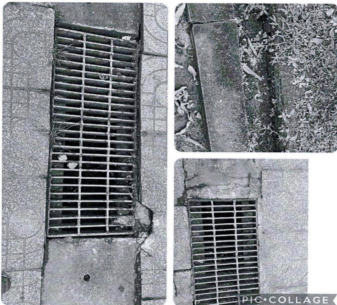
Hình 3.2. Rãnh thu nước mưa chảy tràn không nhiễm xăng dầu
